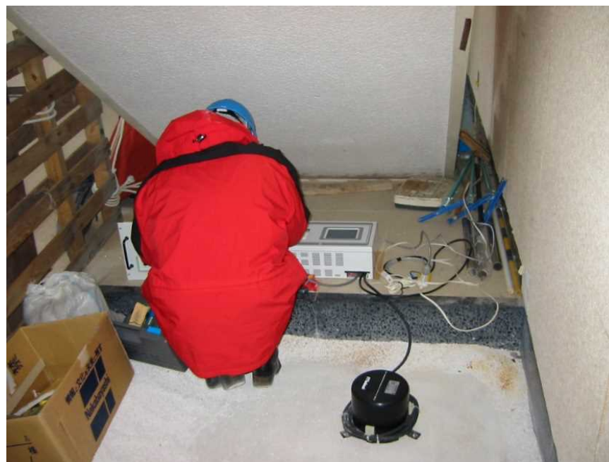
臨時震度計設置・設定作業
