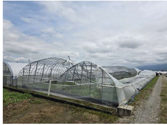
② 農業用ハウスの鋼管の変形
