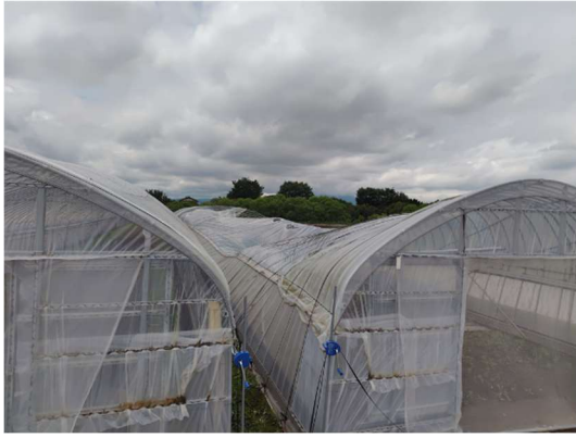
① 農業用ハウスの鋼管の変形
