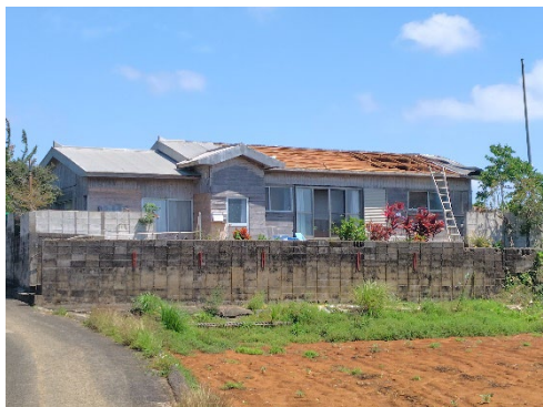
①屋根ふき材がめくれた木造住宅
