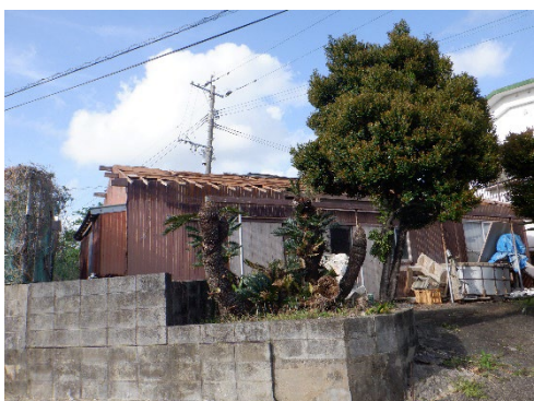
③トタン屋根の剥がれ
