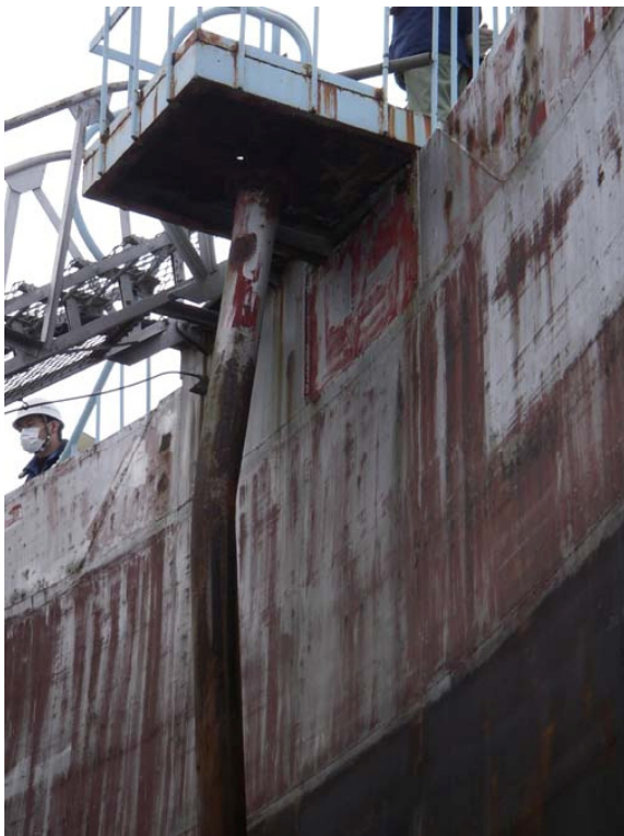
ゲージポールの変形 スロッシング波高約1.4m
