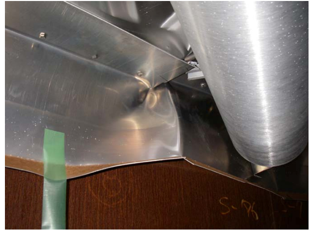
アルミ製内部浮き蓋の破損
