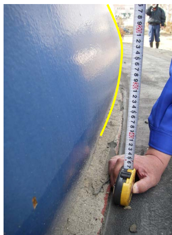
像の足座屈: 仙台
