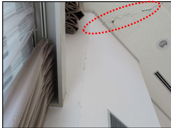
写真2 天井材の落下（階上町道仏）
