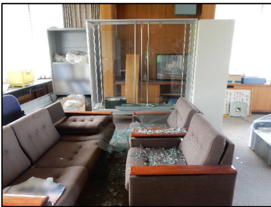
写真3 ガラスの破損（八戸市南郷）
