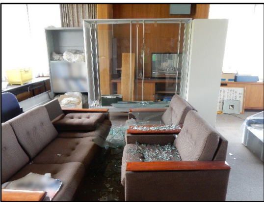
写真3 ガラスの破損（八戸市南郷）
