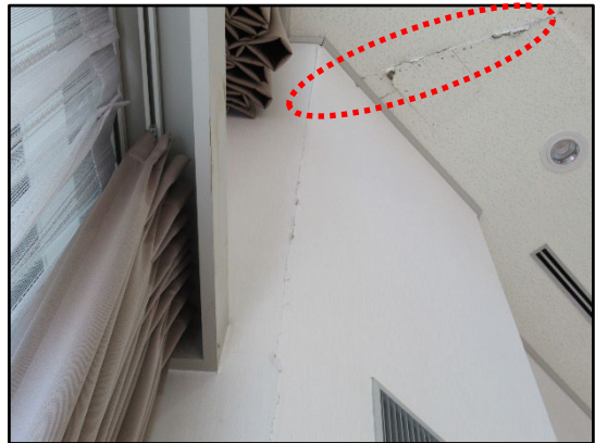
写真2 天井材の落下（階上町道仏）
