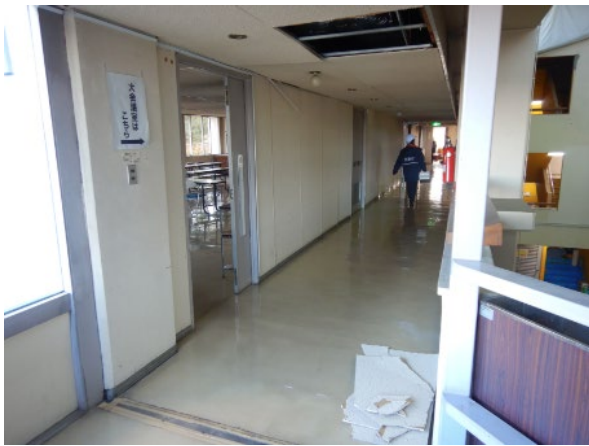
写真1 天井材の落下
