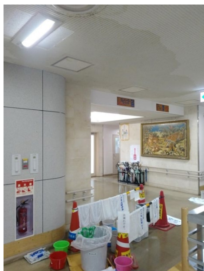
写真3 天井からの水漏れ
