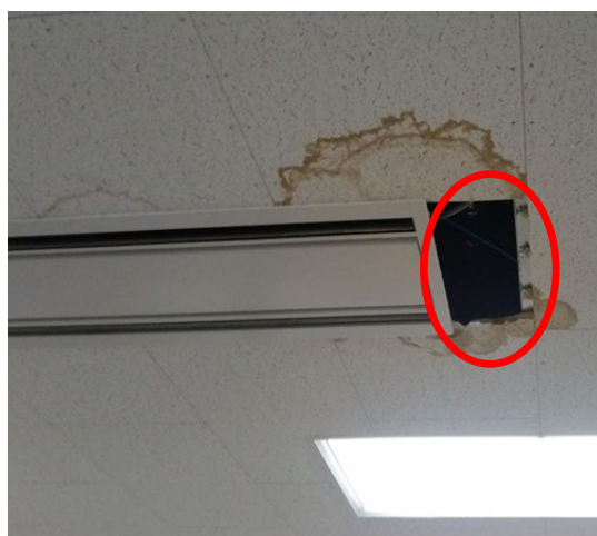
写真4 天井石膏ボード損傷
