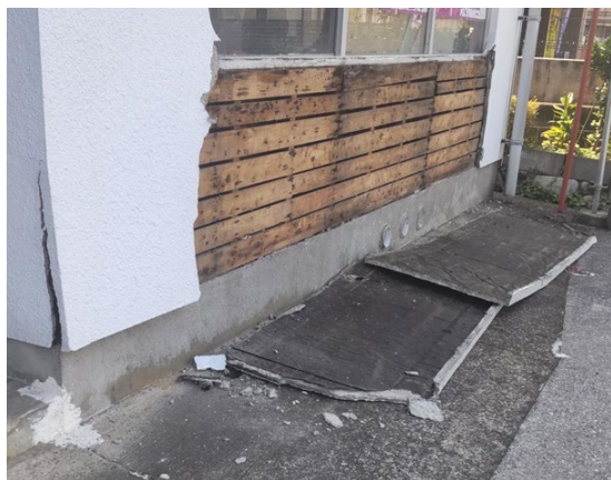
写真1 店舗の壁面剥離
