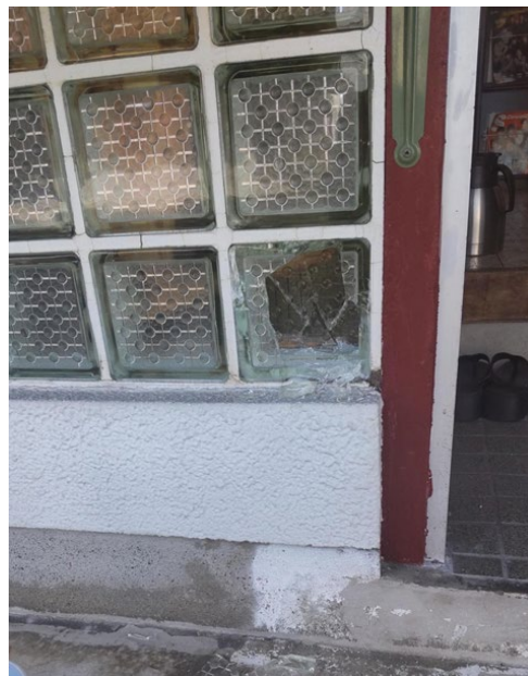
写真2 店舗のガラスの破損
