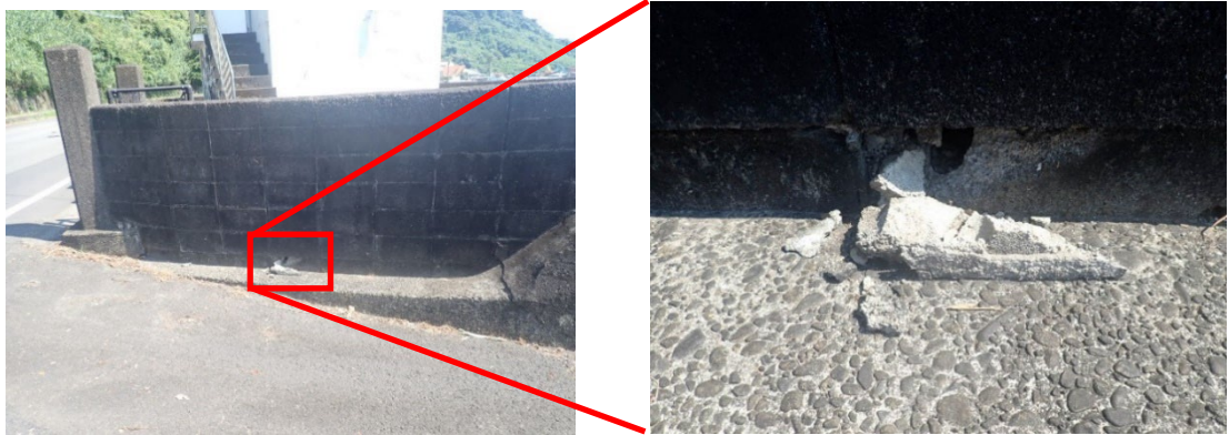
写真5 ブロック塀の一部損壊
