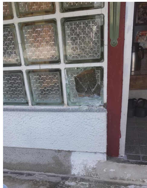
写真2 店舗のガラスの破損
