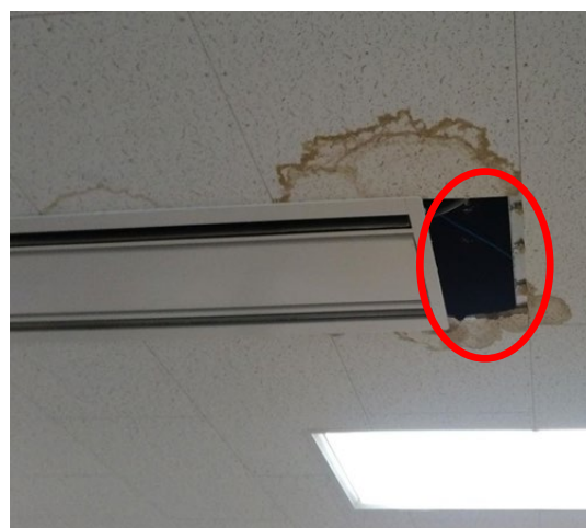
写真4 天井石膏ボード損傷
