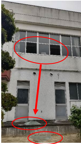
写真1 体育館の窓ガラスの破損
