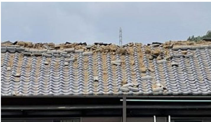
写真7 屋根瓦の落下
