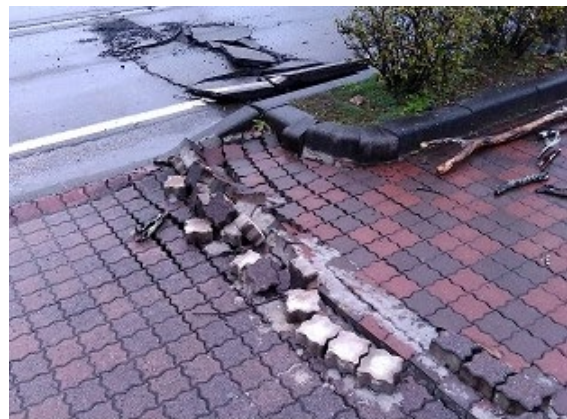
写真8-4：道路の亀裂及び段差
