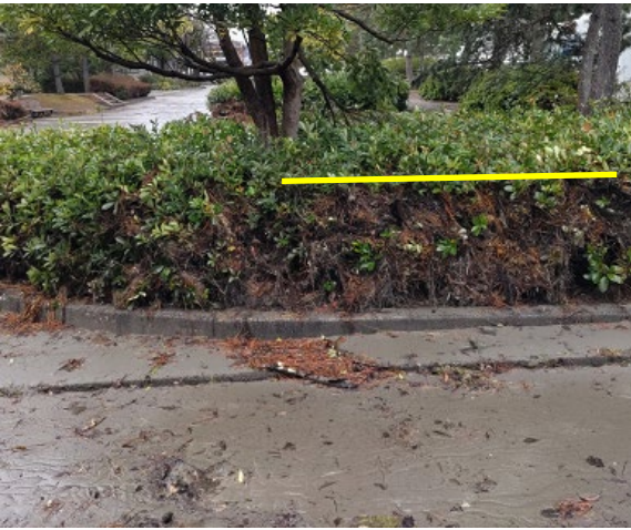
写真8-15：津波の痕跡（珠洲市見附公園）
