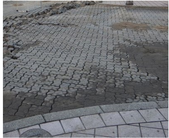
写真8-12：道路の亀裂及び液状化
