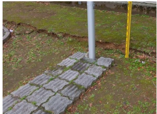
写真8-10：地面のひび割れ及び段差
