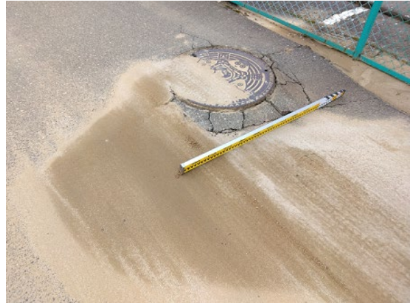
写真8-8：道路の液状化
