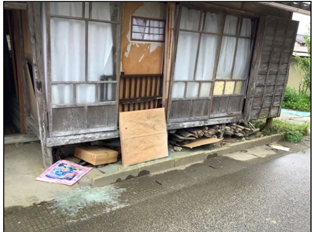
写真2 窓ガラスの破損
