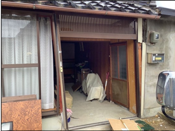
写真1 木造家屋の傾き
