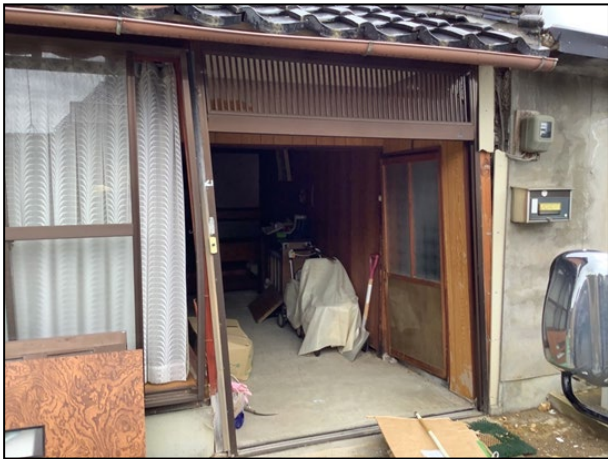
写真1 木造家屋の傾き
