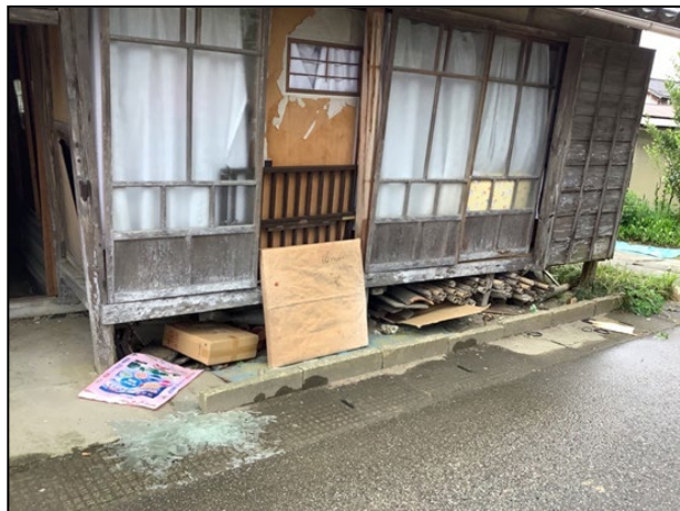
写真2 窓ガラスの破損
