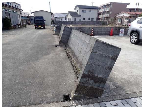
写真8：傾いたブロック塀
