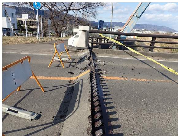
写真10：橋梁接合箇所の破損
