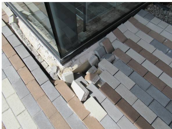
写真7：歩道ブロックの破損
