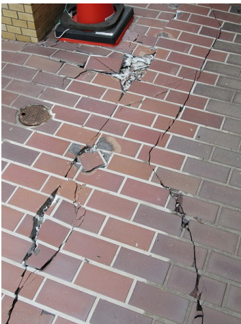
写真5：建物入り口タイル床面の破損
