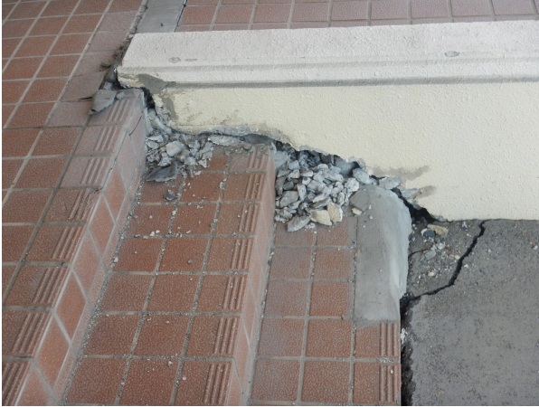
写真1：建物入口階段の破損
