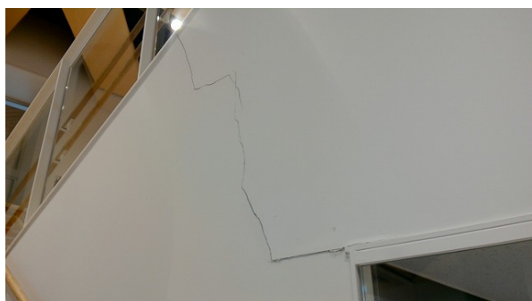
写真9：階段壁面ボードの亀裂
