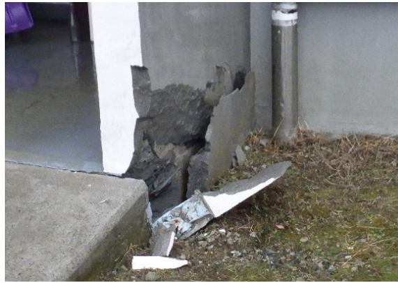
写真7-5 建物入口の壁の損壊
