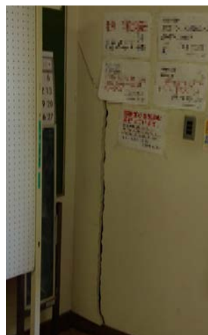
写真7-27 建物内壁の亀裂
