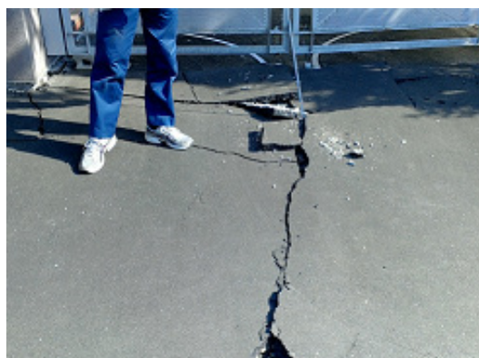
写真7-12 観測点周辺施設の門扉前の舗装割れ
