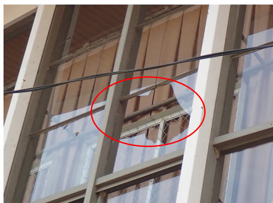
写真7-31 窓ガラスの落下（上：広域、下：狭域）
