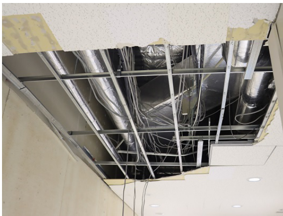
写真7-18 庁舎天井の破損（落下）
