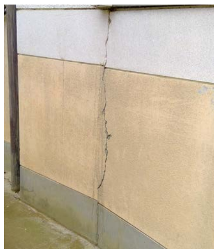
写真7-32 建物外壁の亀裂
