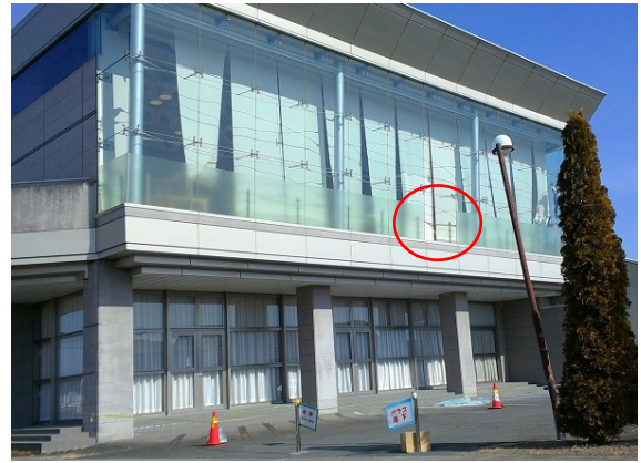
写真7-17 図書館のガラス製の柵の落下
