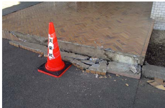
写真7-23 建物玄関段差部分の破損
