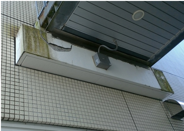
写真7-16 庁舎外壁のモルタル剥離
