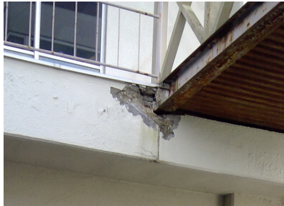
写真7-6 渡り廊下接合部の損壊
