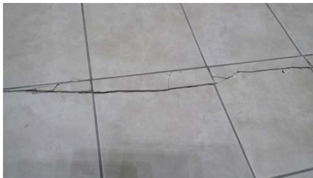
写真7-30 建物床材の亀裂
