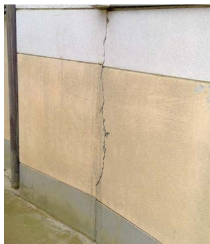
写真7-32 建物外壁の亀裂
