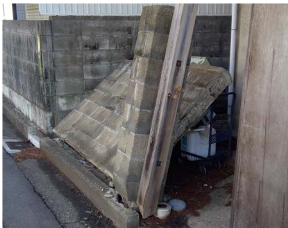
写真7-26 補強されていないブロック塀の倒壊
