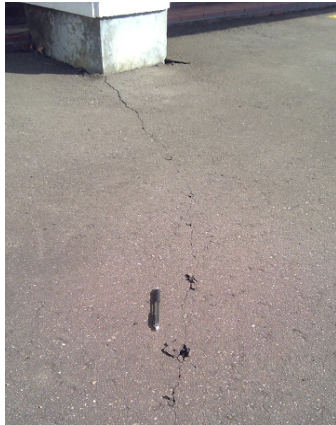
写真7-1 庁舎入り口付近のアスファルト路面に亀裂
