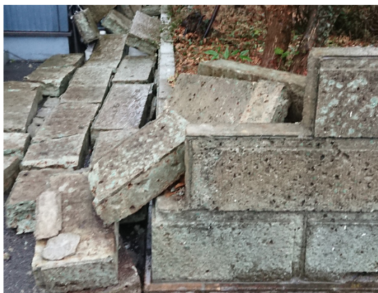
写真7-19 民家の塀の倒壊
