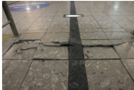
写真7-9 床のタイルの割れ （仙台空港（株）撮影）
