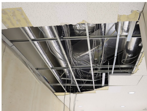
写真7-18 庁舎天井の破損（落下）
