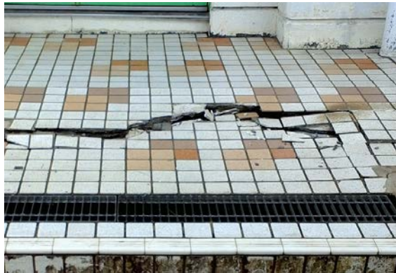
写真7-3 建物玄関の床タイルの破損
