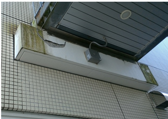
写真7-16 庁舎外壁のモルタル剥離
