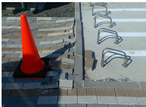
写真7-14 歩道インターロッキングのずれ
