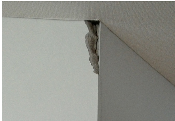
写真7-24 建物内壁の破損
