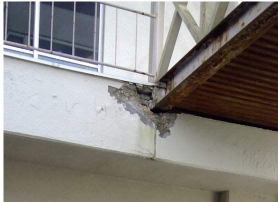
写真7-6 渡り廊下接合部の損壊
