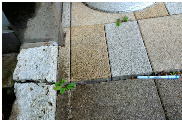
写真7-21 建物入口の床材の隆起および亀裂
