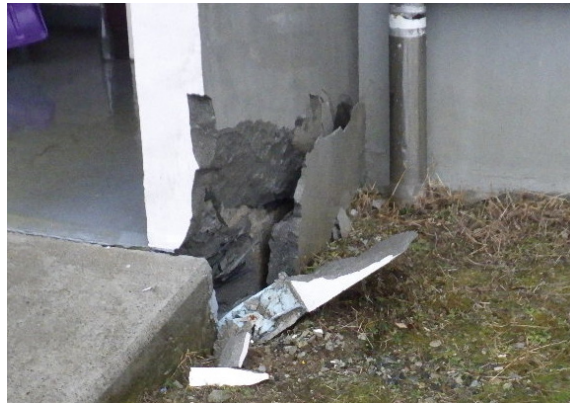
写真7-5 建物入口の壁の損壊
