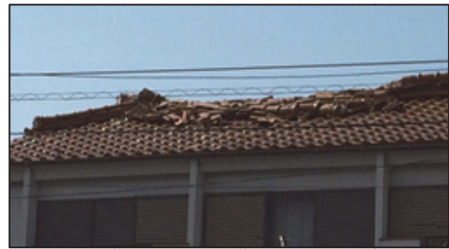
写真 2 民家の屋根損傷（西予市三瓶町）
