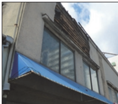
写真 3 住家外壁の損壊と落下（呉市中通）
