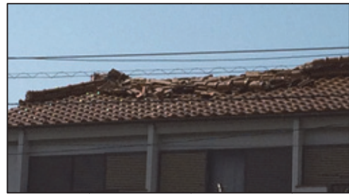
写真 2 民家の屋根損傷（西予市三瓶町）
