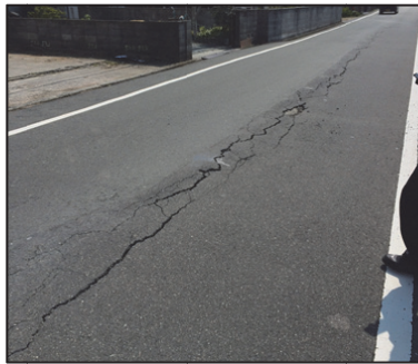
写真 1 道路の亀裂（西予市三瓶町）
