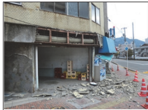
写真 4 住家外壁の損壊と落下（呉市東中央）
