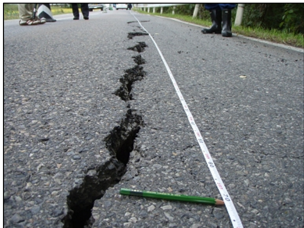
国道 118 号線の路面の亀裂
