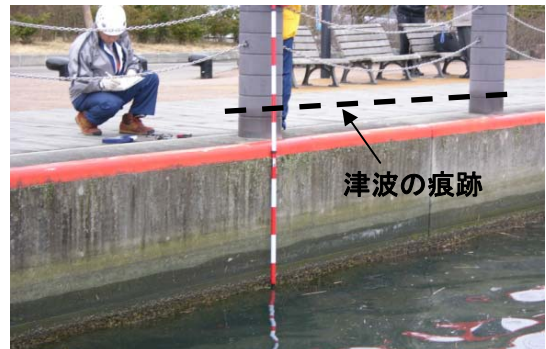
①エースポート付近の棧橋 柱に変色した痕が見られる
