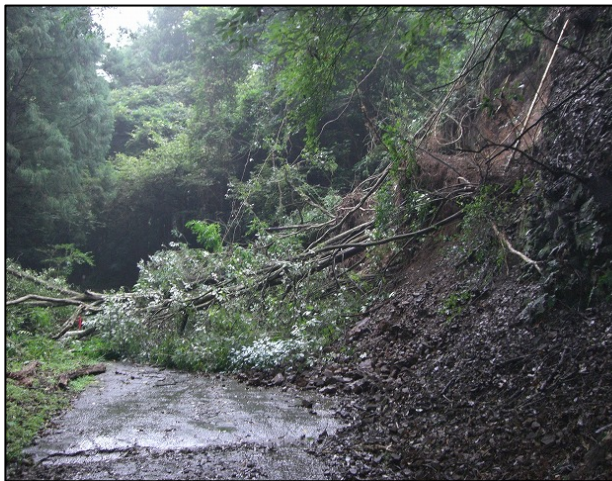
写真 5-5 伊豆市山田川林道 土砂崩れ（伊豆市市山観測点の北東 500m 付近） 幅約 15m、高さ約 15m にわたり土砂崩れが発生
