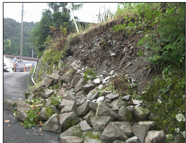
写真 5-6 伊豆市西平地区の石垣 石垣崩落（伊豆市市山観測点の南約 1.2km 付近） 西平地区で石垣が崩れ道路にまでかかっていた。
