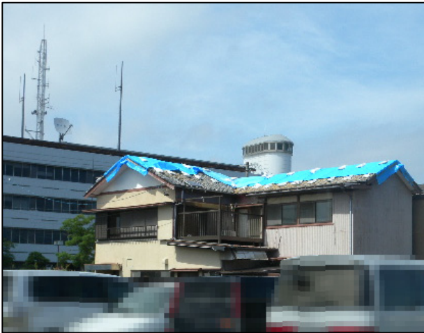
写真 5-3 牧之原市相良震度観測点付近 屋根瓦が落下しブルーシートで補修
