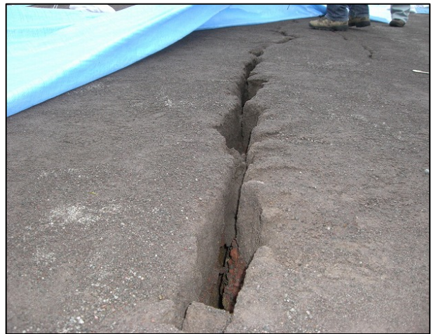
写真 5-4 伊豆市天城中学校のグラウンド 地面の亀裂（伊豆市市山観測点の北 2 km 付近） グラウンド北側長さ約 80m、幅約 20m の範囲に地割れが数箇所発生
