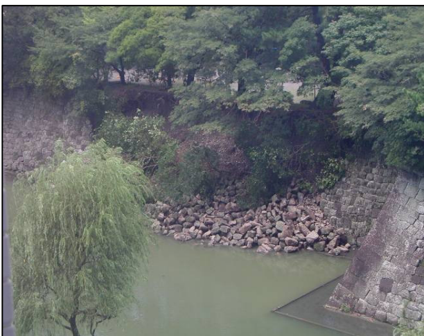
写真 5-7 静岡市葵区駿府城跡 石垣が崩落（静岡葵区駒形通観測点の北東 1.6km 付近）
