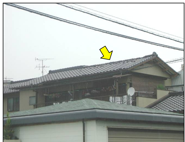
写真 5-8 静岡駿河区曲金震度観測点付近 屋根瓦が破損（矢印箇所）
