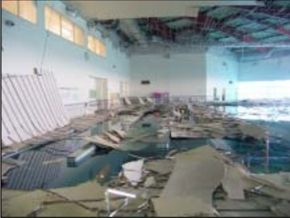
写真 2 - 3 プールの天井パネルが落下（ ）
