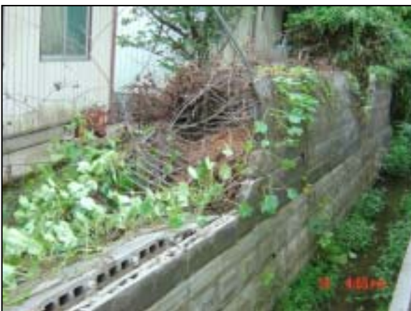
写真 2 - 1 ブロック塀の倒壊（ ）
