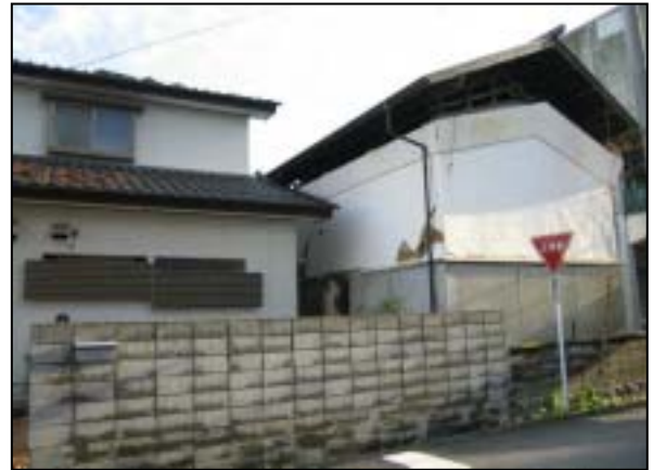
写真 2 - 6 民家の土蔵の壁破損（ ）
