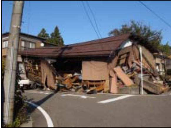
写真 2-9 倒壊した家屋
