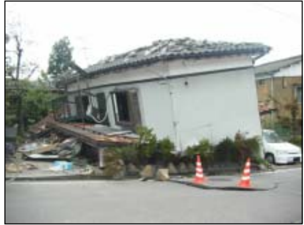
写真 2-12 1 階部分が潰れた家屋
