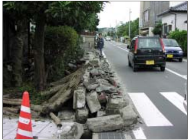
河南町新田 (2003.07.27) 塀の倒壊
