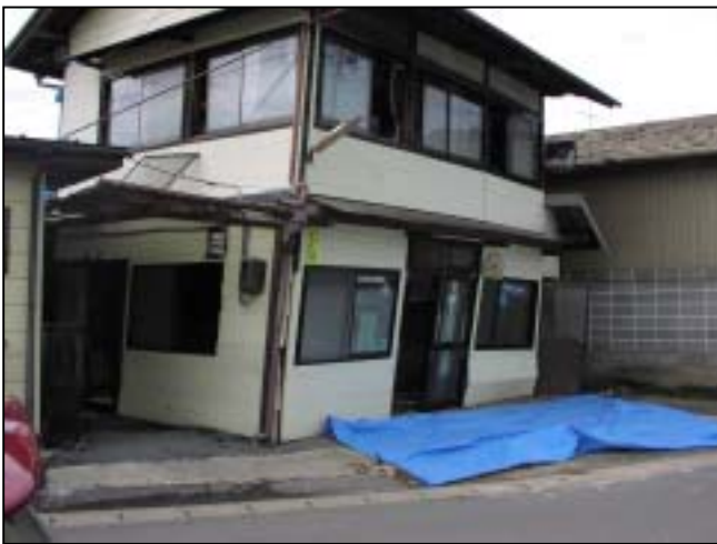
南郷町町役場付近 (2003.07.27) 民家の被害
