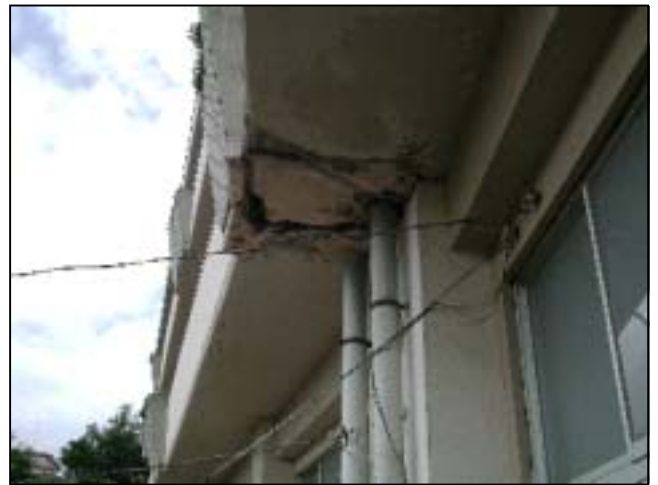
鹿島台町の小学校 (2003.07.27) 新旧つなぎ目亀破損
