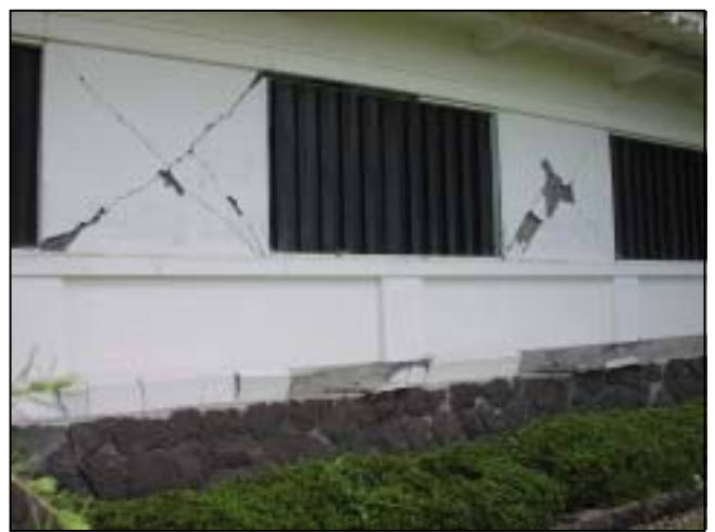
涌谷町涌谷城 (2003.07.27) 涌谷城壁のせん断
