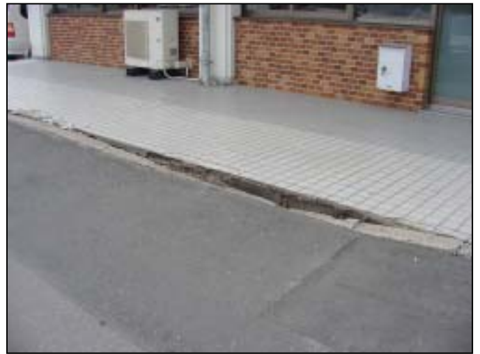
涌谷町役場 (2003.05.27) 玄関(新庁舎)の地盤沈下
