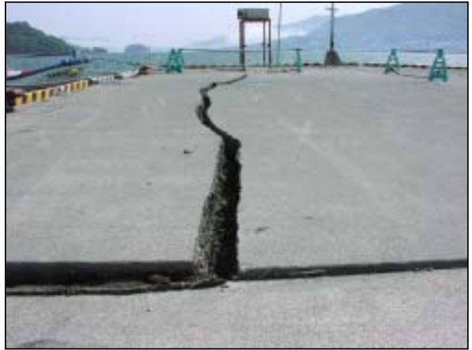
大船渡市赤碕地区 (2003.05.28) ケースンの亀裂
