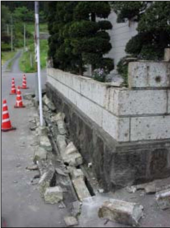
栗駒町 (2003.05.27) ブロック塀の倒壊
