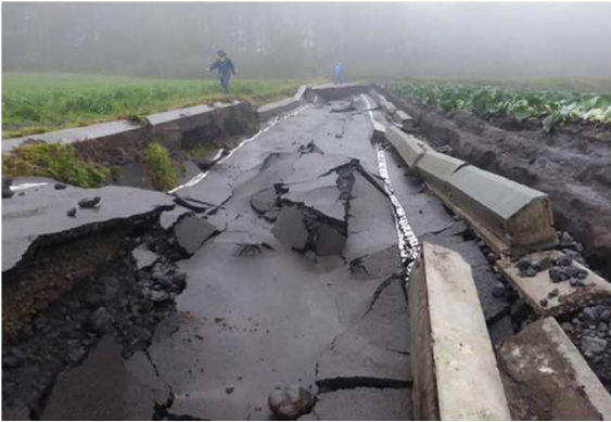
写真1 吾妻郡嬭恋村田代糠塚(農道崩壊)
