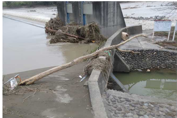
写真4 藤岡市上落合(鎗川中村堰、頭首工の土砂堆積)
