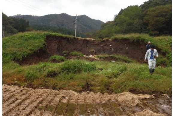
写真2 利根郡みなかみ町入須川(農地の法面崩落)
