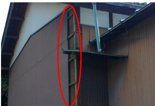
① 住家の壁の損傷 (北西方向から撮影)
