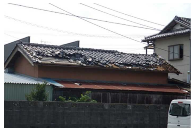
瓦屋根が飛散した非住家 (北東方向から撮影)
