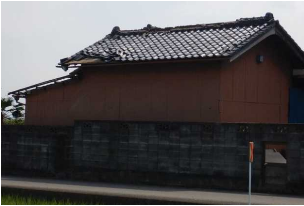
瓦屋根が飛散した非住家 (北北西方向から撮影)
