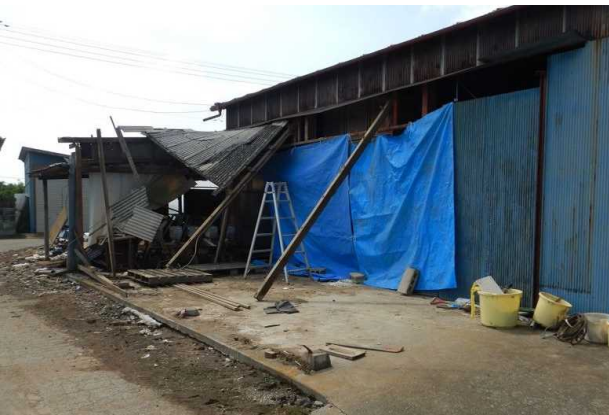
一部が飛散した非住家 (北東方向から撮影)
