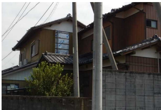
外壁と瓦屋根が飛散した住家 (北西方向から撮影)
