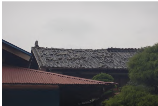
屋根瓦のめくれ及び一部瓦が飛散した 住家 (南方向から撮影)
