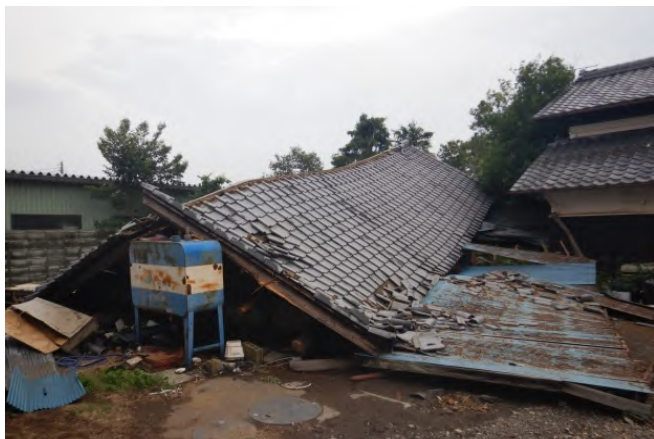
倒壊した非住家 (北西方向から撮影)
