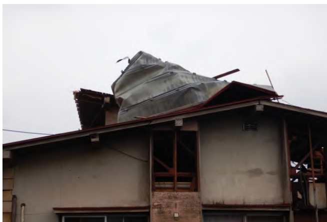
トタン屋根がめくれ一部が飛散した住家 (東方向から撮影)
