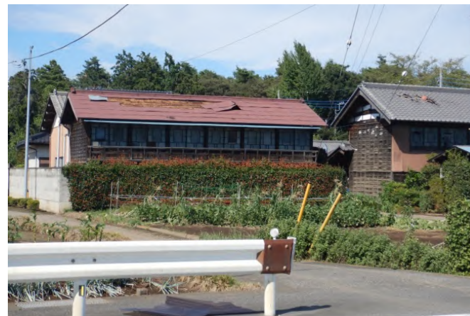
屋根のトタンと瓦がめくれた住家 (南方向から撮影)
