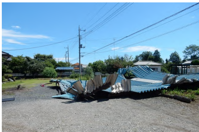
飛散したトタン屋根 (北西方向から撮影)
