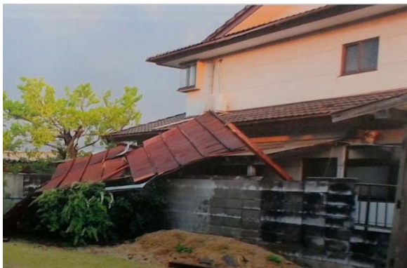
③ 損壊した住家（屋根） （北西から撮影）
