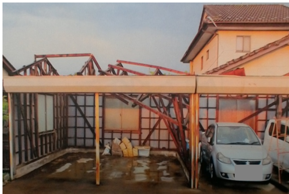
② 損壊した車庫（屋根が飛散） （西から撮影）
