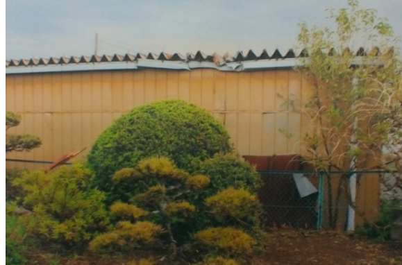
④ 損壊した倉庫（屋根） （西から撮影）
