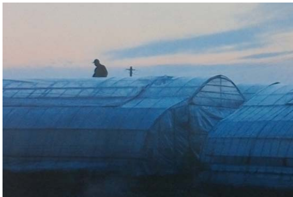
① はく離したビニールハウス（修復済み） （東から撮影）
