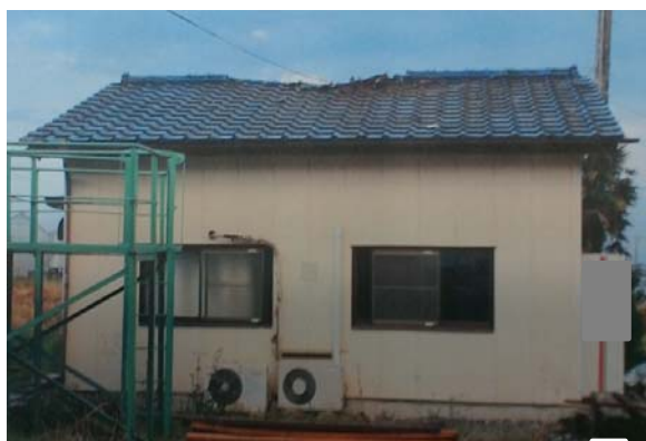
⑤ 損壊した倉庫（屋根） （南から撮影）
