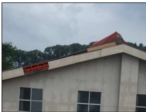
飛散した体育館の屋根 (北西から撮影)
