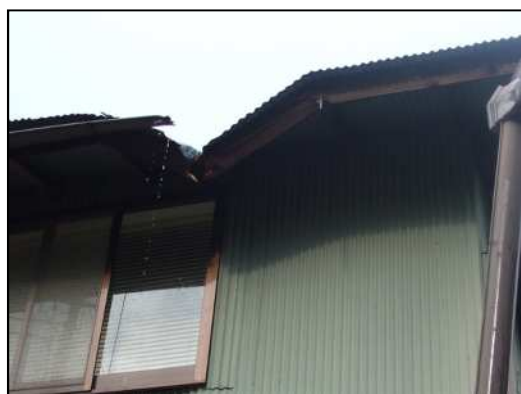
飛散物によって損壊した倉庫 (南西から撮影)
