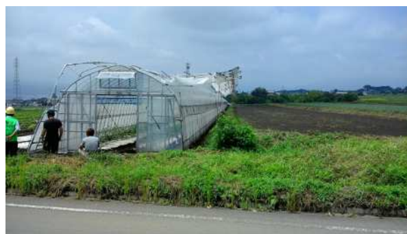
鋼管が変形したパイプハウス (南東から撮影)
