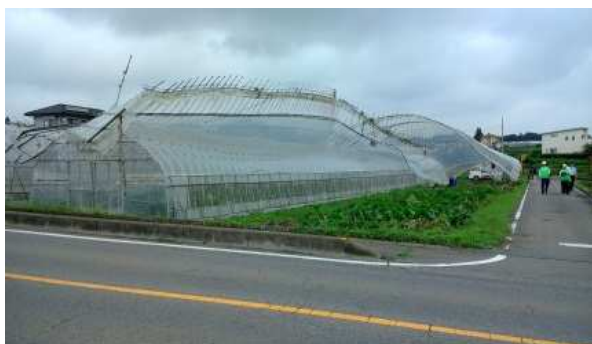
鋼管が変形、倒壊したパイプハウス (北西から撮影)
