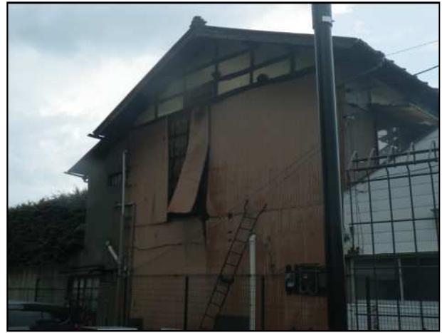
トタン壁が剥がれた住家（南から撮影、伊勢崎市消防本部提供）
