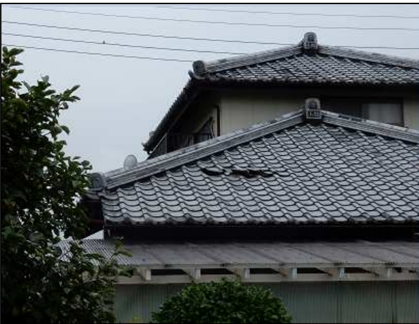
瓦がめくれた住家（南から撮影）
