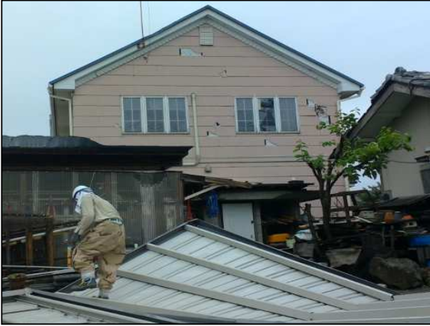
車庫の飛散により破損した住家の外壁、窓ガラス（南西から撮影）
