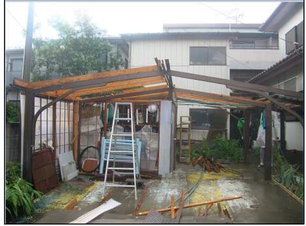
屋根が破損した車庫（南から撮影、伊勢崎市消防本部提供）
