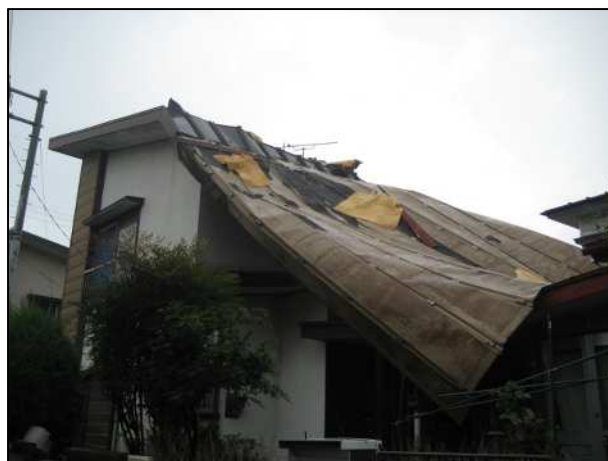
トタン屋根がめくれた住家(本庄市) (北東から撮影、本庄市提供)
