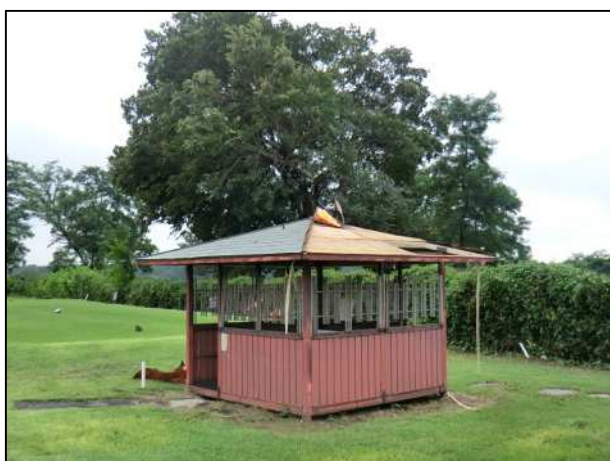
銅板の屋根がめくれ、飛散したゴルフ 場の雷避難小屋(上里町) (南東から撮影)
