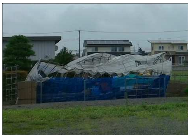
鋼管が変形したパイプハウス （南西から撮影）
