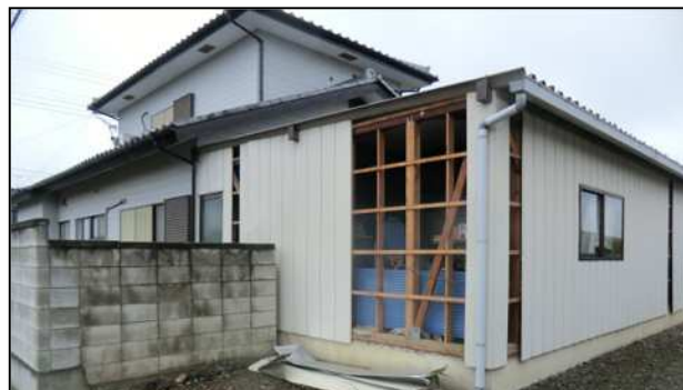
外壁(トタン)が剥がれた車庫 （北西から撮影）
