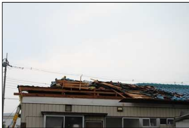
屋根が飛んだ住家（北西から撮影） 伊勢崎市提供
