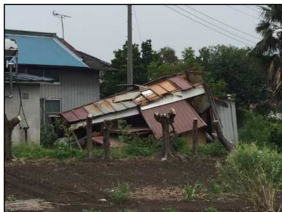
倒壊した物置 （北北東から撮影）
