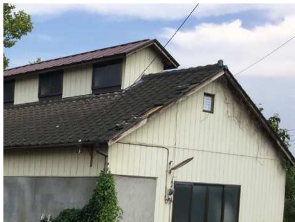
屋根瓦がめくれた倉庫 (北西から撮影)
