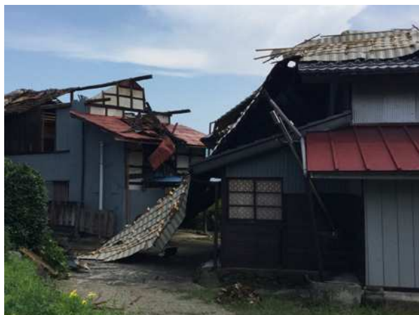
トタン屋根がめくれた住家と物置 (北西から撮影)
