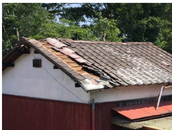
屋根瓦がめくれた住家 (南西から撮影)
