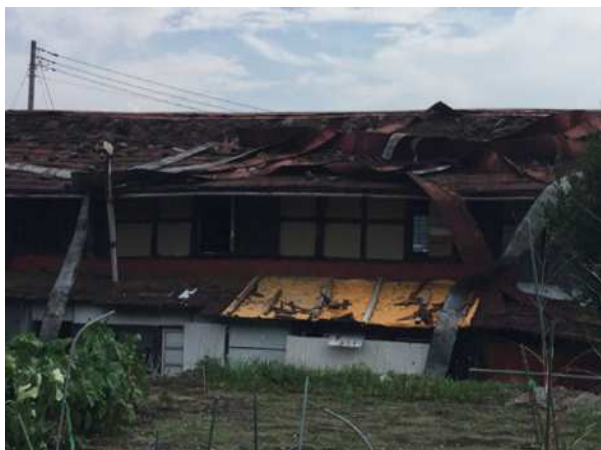
トタン屋根がめくれた住家 (北東から撮影)
