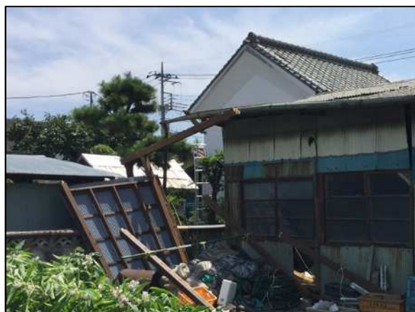
トタン屋根がめくれた非住家 (北西から撮影)
