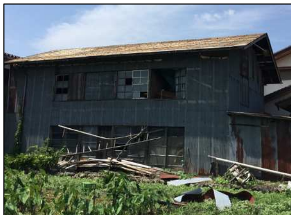
トタン屋根がめくれた非住家 (北東から撮影)
