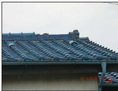
屋根瓦が落下した住家 (前橋市鳥羽町)
