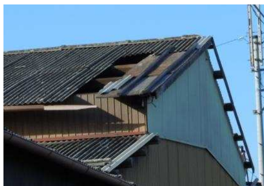
スレート屋根の一部が飛散した 非住家 (埼玉県行田市南河原)
