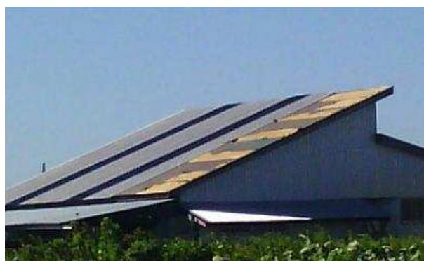
トタン屋根の一部が飛散した非住家 (埼玉県行田市馬見塚)
