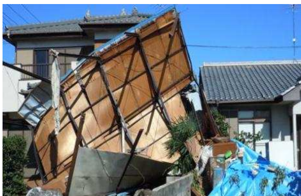
倒壊した物置 (埼玉県行田市和田)
