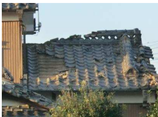
屋根瓦が飛散した住家 (埼玉県熊谷市妻沼)
