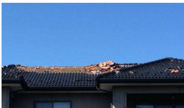
屋根瓦が飛散した住家 (埼玉県熊谷市御正新田)
