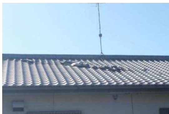
屋根瓦がめくれた住家 (埼玉県行田市和田)
