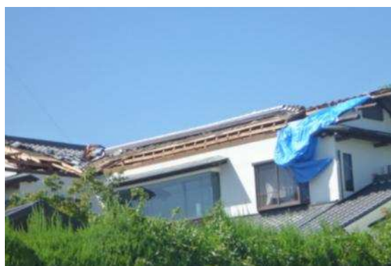
屋根の一部と屋根瓦が飛散した住家 (埼玉県行田市南河原)
