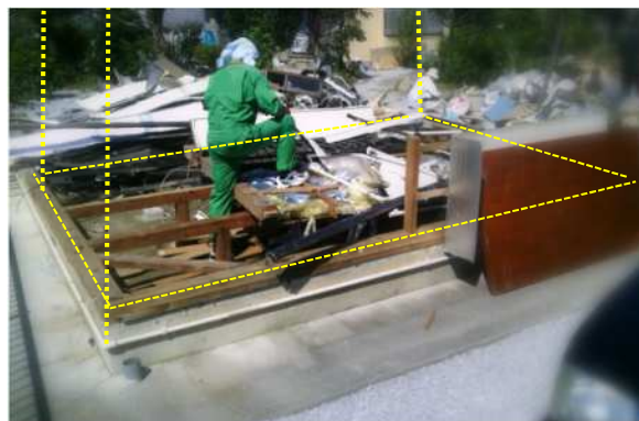
倒壊し、基礎と土台のみとなった住家 (埼玉県熊谷市西城)
