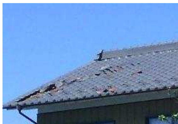
屋根瓦がめくれた住家 (埼玉県行田市南河原)
