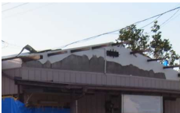
屋根のトタンが飛散した非住家 (埼玉県熊谷市江波)
