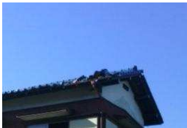
屋根瓦がめくれた住家 (埼玉県熊谷市東別府)
