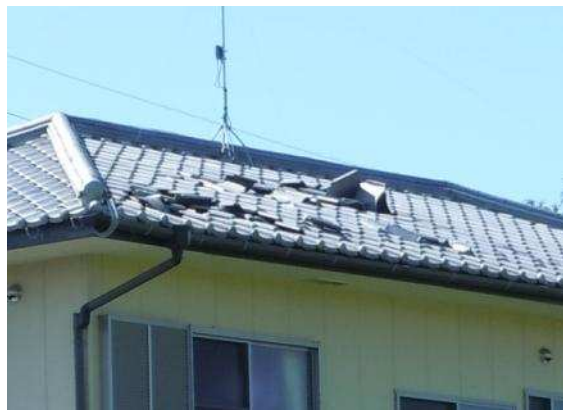
屋根瓦がめくれた住家 (埼玉県行田市中江袋)
