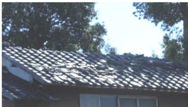
屋根瓦がめくれた住家 (埼玉県行田市和田)
