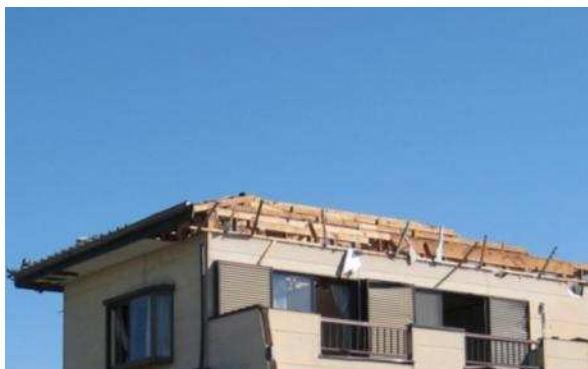
屋根の一部が飛散した住家 (埼玉県熊谷市四方寺)
