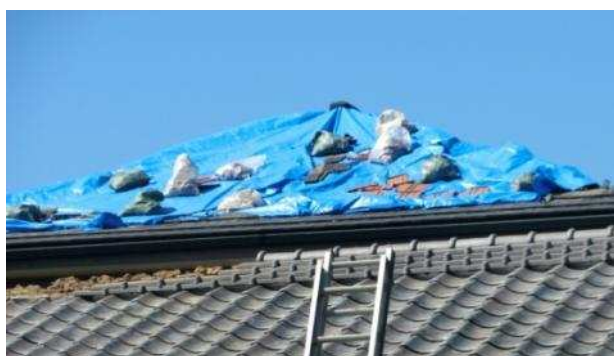
屋根瓦が飛散した住家（修復作業中） (埼玉県熊谷市御正新田)
