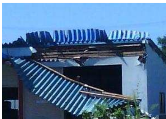
トタン屋根の一部が損壊した車庫 (埼玉県行田市中江袋)
