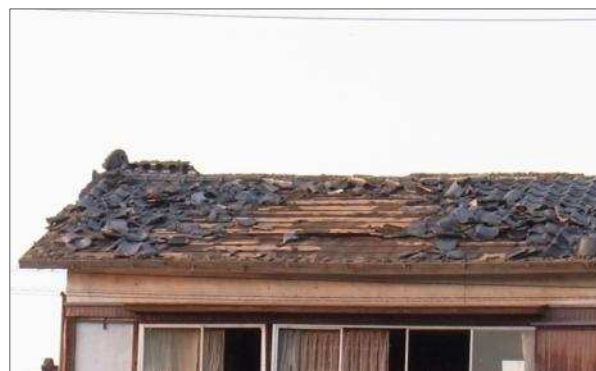
屋根瓦が飛散した住家 (埼玉県熊谷市八ツ口)
