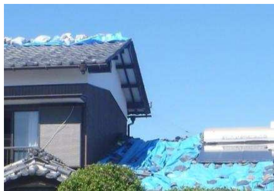
屋根瓦が飛散した住家(修復作業中) (埼玉県行田市南河原)
