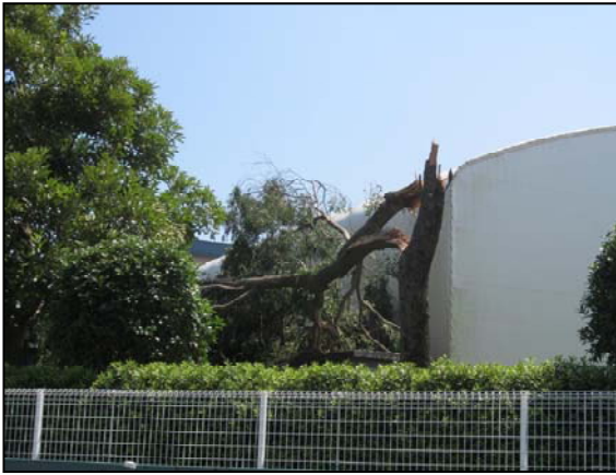
① 幹の折れた樹木（直径約30cm） （栃木県足利市：北東から撮影）
