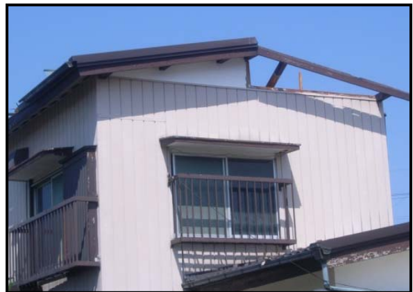
④ 住家屋根の損壊 （群馬県邑楽郡邑楽町：北西から撮影）
