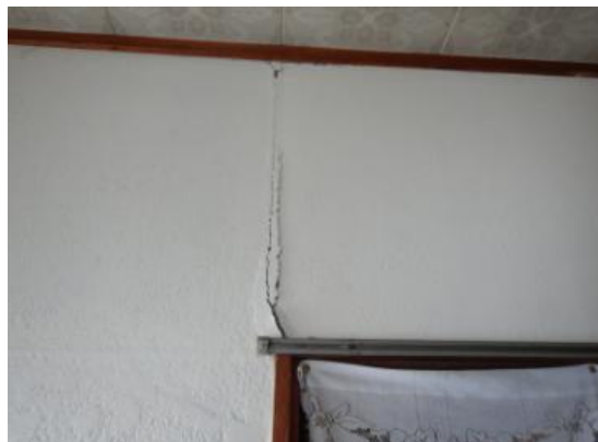
写真 1 民家の壁の亀裂（八戸市湊町）
