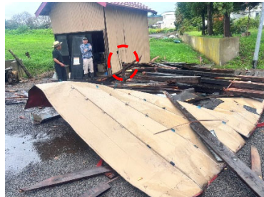
⑤非住家の壁破損(北から撮影)
