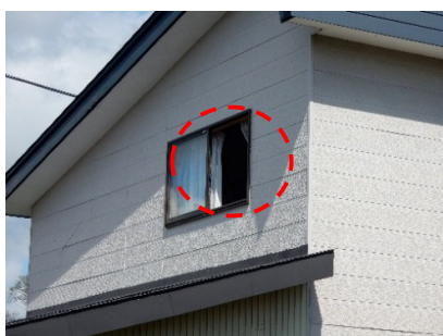
③非住家の2階窓破損(西から撮影)
