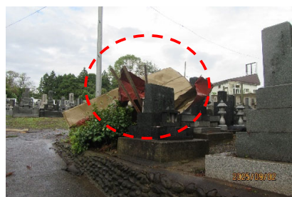
⑥墓地に郷蔵の屋根の一部が飛散(南東から撮影)
