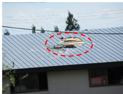
④非住家の2階屋根破損(南から撮影)
