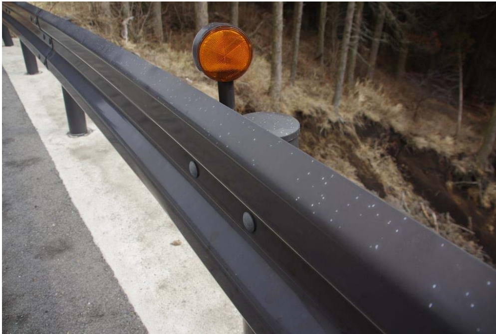
図 2 阿蘇山 4 日 06 時 56 分頃に発生した噴火の現地調査で確認した降灰の状況 ガードレールに付着した灰白色のわずかな火山灰を確認しました。
