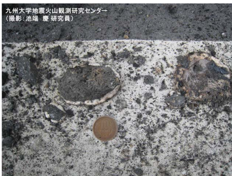
第4図 車道外側線（白線）上に落下した噴石。噴石の下に塗料が溶融し、一部は泡立っている。一般的な溶融型粉体塗料の軟化温度は100-110℃、溶融温度は130-140℃であるので、落下時の噴石の表面温度は100℃を超えていたことが推測される。なお、アスファルト上に落下した噴石の下は焼かれた跡が残っていた。
