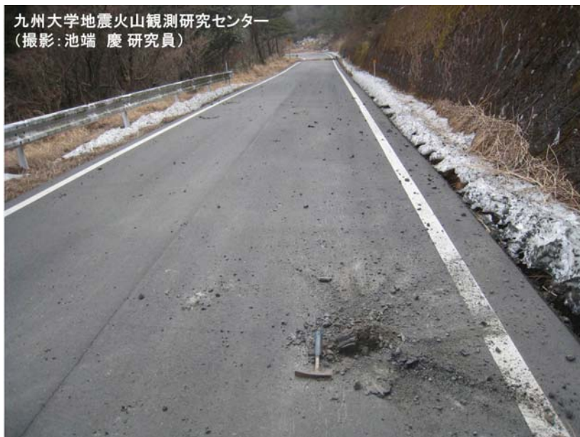
第3図 噴石（長径27cm、短径16cm）が県道104号線道路のアスファルトにめり込んでいる（深さ7cm）。アスファルトには噴石着弾時に形成されたと考えられる亀裂が確認された。道路上及び道路脇には、長さ約70mにわたって長径10cm以下の噴石が多数散在している。
