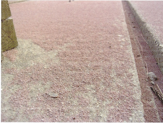
(a) 10月16日撮影 コンクリート塀 (a) Ejecta on a concrete wall, shot on October 16.
