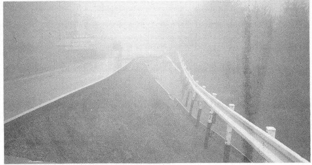
写真2 地震による道路損壊
