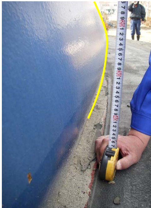
像の足座屈: 仙台
