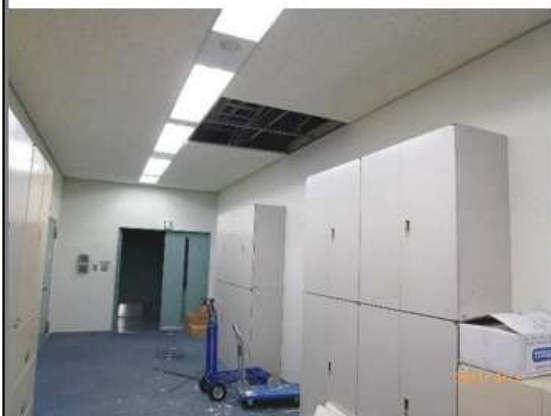
14F (天井パネルの落下)
