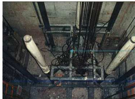
エレベーターケーブルの絡まり (本学の写真ではありません)
