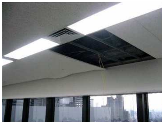
28F (天井パネルの落下)
