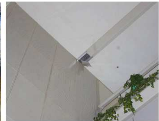
1F (アトリウム:EPJパネルの被害)
