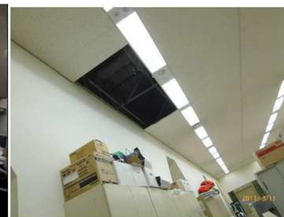
21F (天井パネルの落下)
