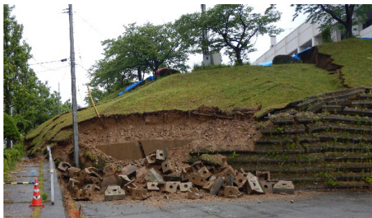
写真1 のり面の一部崩壊
