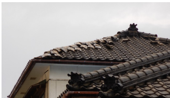
写真3 屋根瓦の崩落
