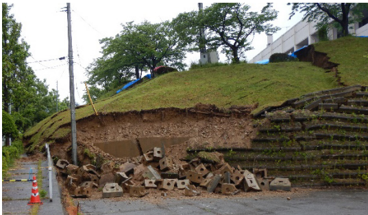
写真1 のり面の一部崩壊
