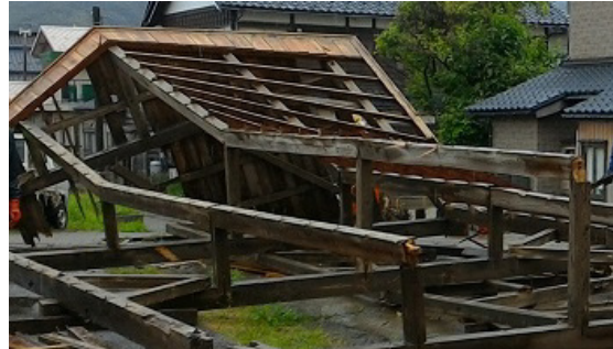
写真4 駐輪場の倒壊
