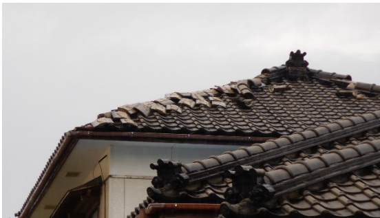
写真3 屋根瓦の崩落
